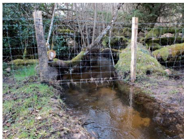
Le franchissement de cours d'eau est à prendre en compte lors des travaux d'installation de la clôture pour éviter une éventuelle dégradation des milieux aquatiques par les engins. Des dispositifs temporaires de franchissement sont parfois nécessaires.
