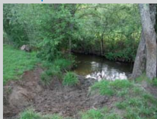
Erosion de berges
