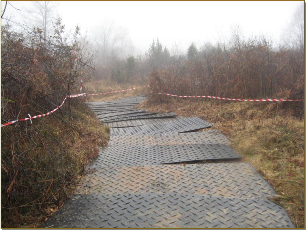
Plaques permettant l'accès aux pylônes tout en épargnant autant que faire se peut la végétation
